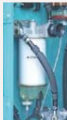
Filtro principal de combustible
